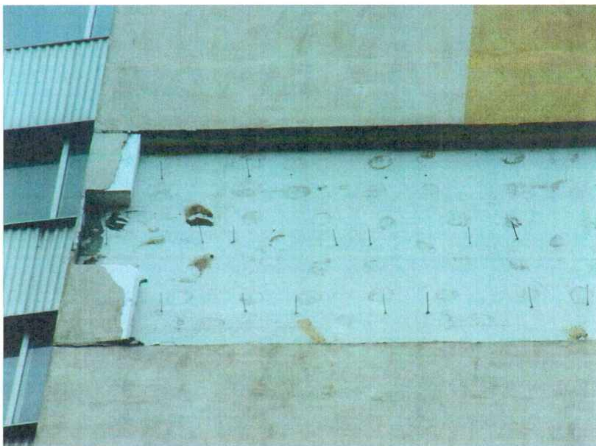
Фото 4: Фрагмент обрушения утеплителя торцевого фасада по оси «1»
