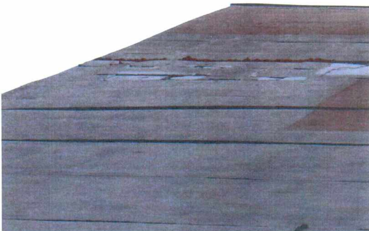
Фото 3: Фрагмент выпучивания плит утеплителя фасада по оси «2» в уровне 10-11 эт
