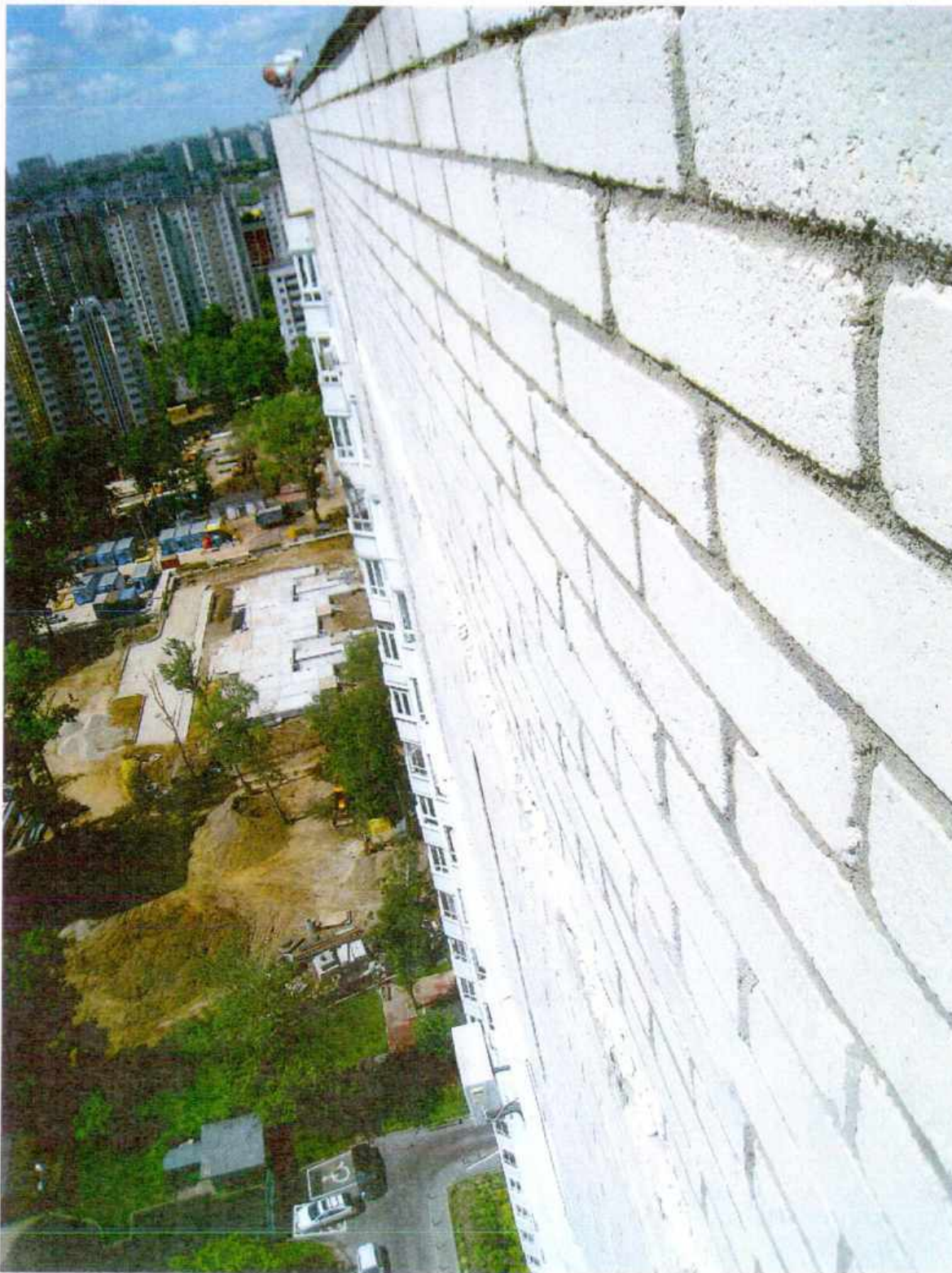
Фото 7. В уровне перекрытия над техническим этажом в габаритах части помещений №№ 11, 12, 13, 18 (смотри план БТИ) смещение плоскости парапета крыши вовнутрь до 40мм
