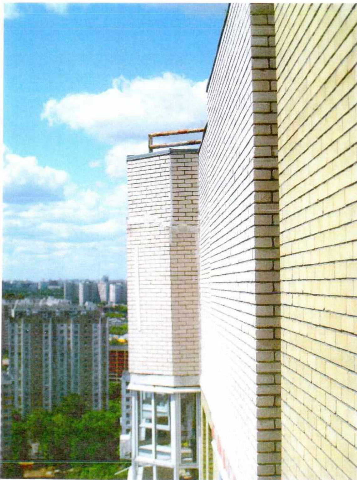
Фото 4. Отклонение плоскости наружной стены со стороны фасада в габаритах части помещений №№11,12,13,18 (смотри план БТИ) в уровне технического этажа от вертикали наружу с увеличением отклонения в верхней части, в уровне перекрытия над техническим этажом - смещение плоскости парапета крыши вовнутрь до 40мм
