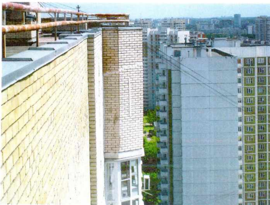
Фото3. Отклонение плоскости наружной стены со стороны фасада в габаритах части помещений №№11,12,13,18 (смотри план БТИ) в уровне технического этажа от вертикали наружу с увеличением отклонения в верхней части, в уровне перекрытия над техническим этажом - смещение плоскости парапета крыши вовнутрь до 40мм
