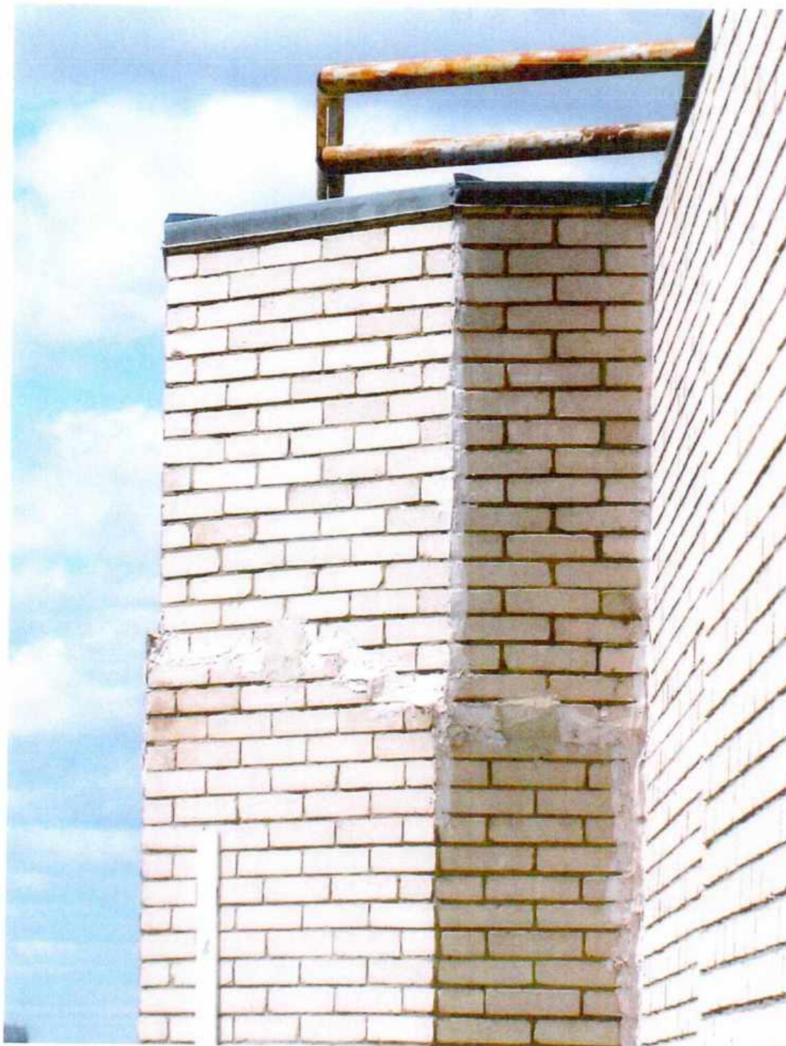
Фото 5. Отклонение плоскости наружной стены со стороны фасада в габаритах части помещений №№11,12,13,18 (смотри план БТИ) в уровне технического этажа от вертикали наружу с увеличением отклонения в верхней части, в уровне перекрытия над техническим этажом - смещение плоскости парапета крыши вовнутрь до 40мм
