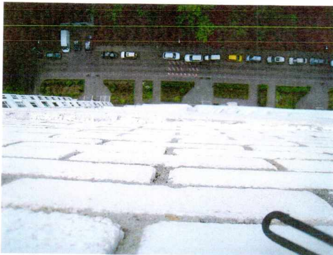
Фото 8. В уровне перекрытия над техническим этажом в габаритах части помещений №№11,12,13,18 (смотри план БТИ) смещение плоскости парапета крыши вовнутрь до 40мм
