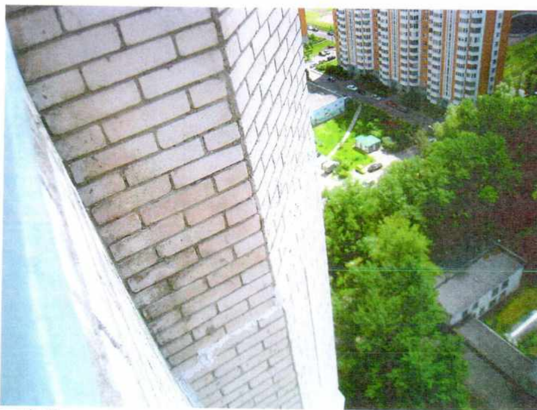
Фото 9. В уровне перекрытия над техническим этажом в габаритах части помещений №№11,12,13,18 (смотри план БТИ) смещение плоскости парапета крыши вовнутрь до 40мм
