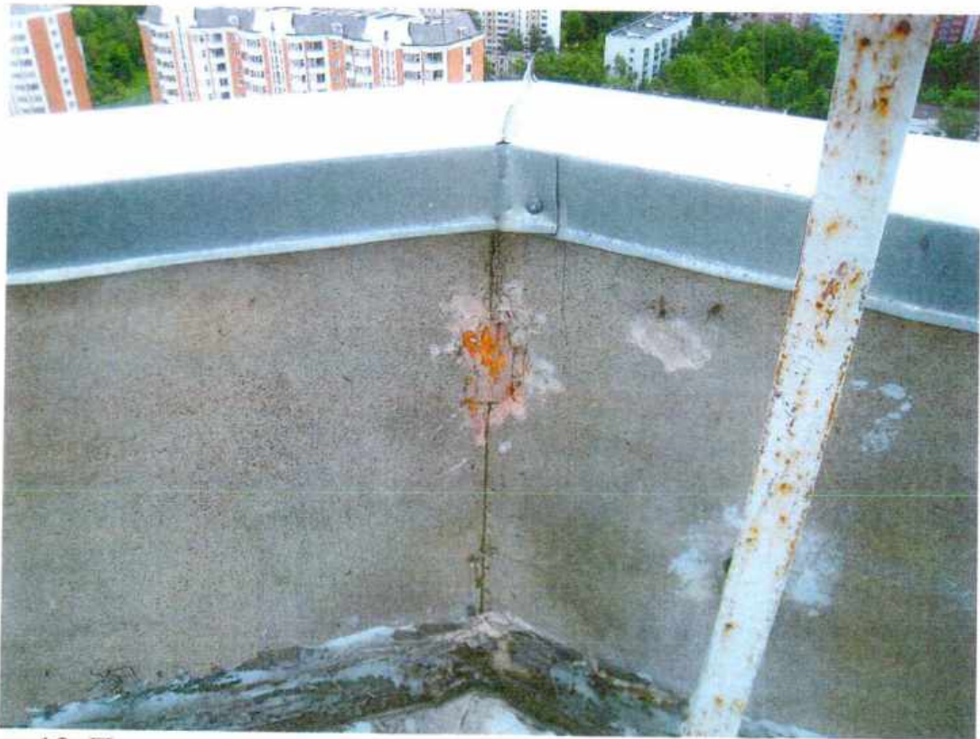
Фото 12. Парапет крыши над техническим этажом в габаритах части помещений №№11,12,13,18 (смотри план БТИ)
